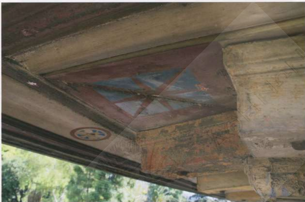
Εικ. 29. Η στέγη του κτηρίου Ziller πριν τις εργασίες συντήρησης και αποκατάστασης.
