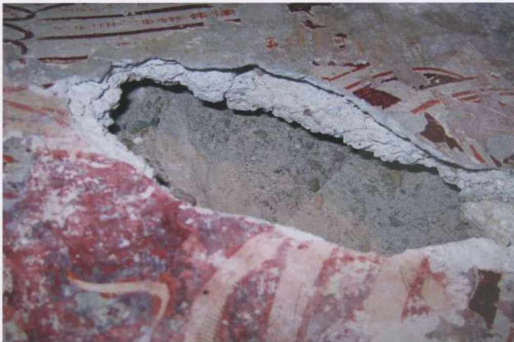
Εικ. 5. Απώλεια και αποκόλληση του υποστρώματος.
