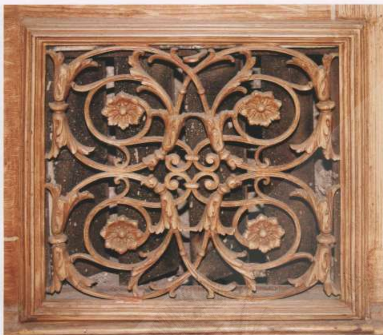
Εικ. 23. Αεραγωγός παρά το δάπεδο μεταφοράς θέρμανσης του Διοικητηρίου (κτήριο Ziller).
