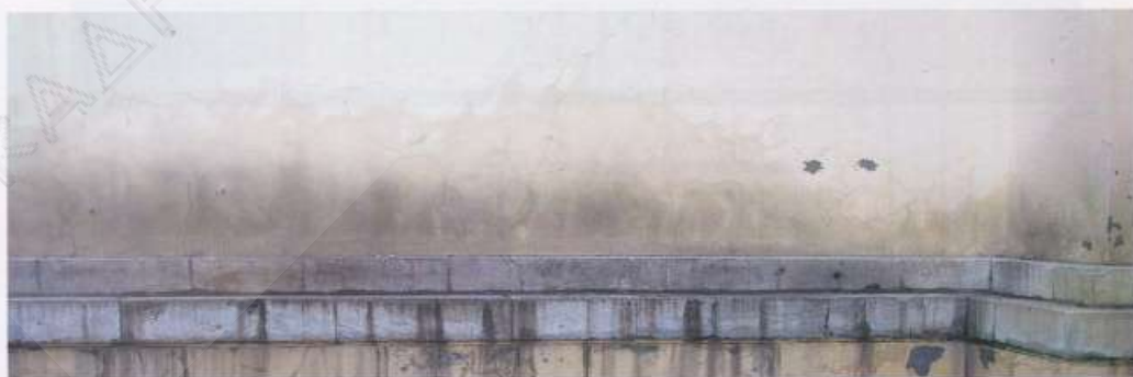
Εικ. 4. Άποψη του εξωτερικού τοίχου, όπου διακρίνεται η ανερχόμενη υγρασία από τα θεμέλια του κτηρίου.
