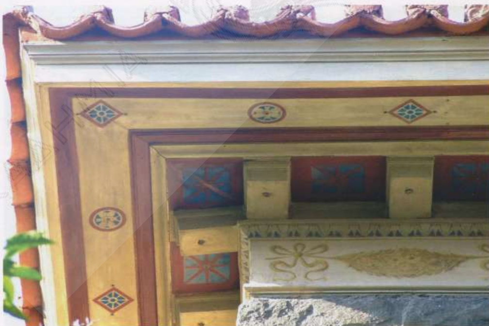
Εικ. 30. Η στέγη του κτηρίου Ziller μετά τις εργασίες συντήρησης και αποκατάστασης.
