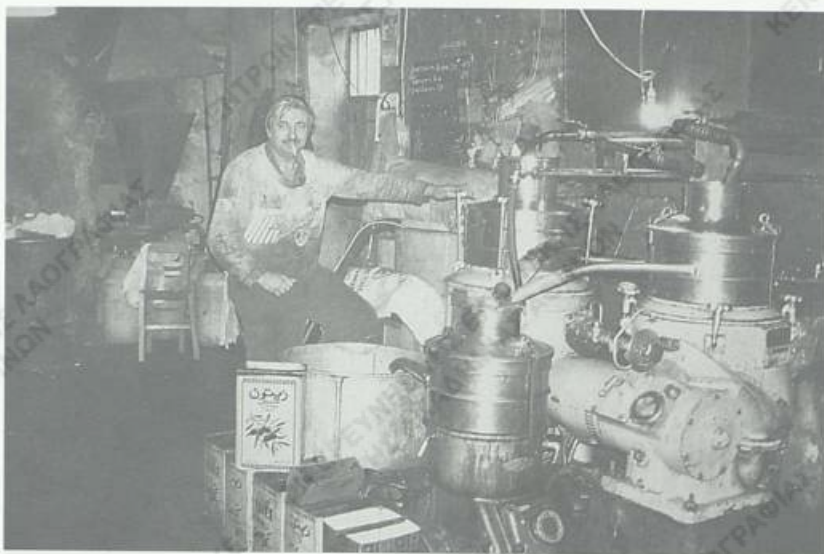
Εικ. 11. Ο διαχωριστήρας σε ηλεκτροκίνητο «κλασικό» ελαιοτριβείο (Χρυσάφα Λακωνίας, Φ. Α. ΠΤΙ. ΕΤΒΑ, φωτ. Π. Μπαγετάκου).
